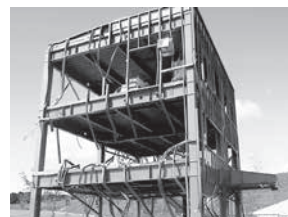
被災後、南三陸防災庁舎
